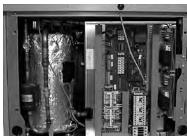
Příklad otevřené elektrické rozvaděčové skříně
