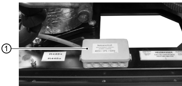
1 Elektrická připojovací skříňka: Síťová přípojka tepelného čerpadla
